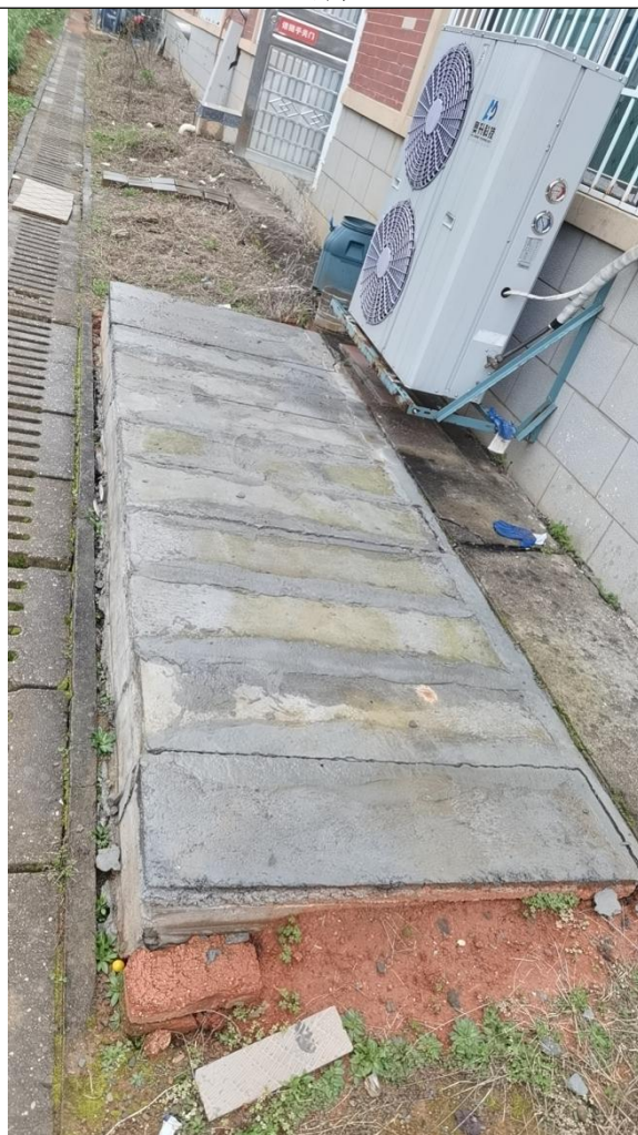
污水处理设施（沉淀池）
