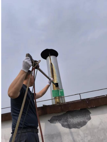
3#车间沸腾干燥粉尘排气筒DA006采样
