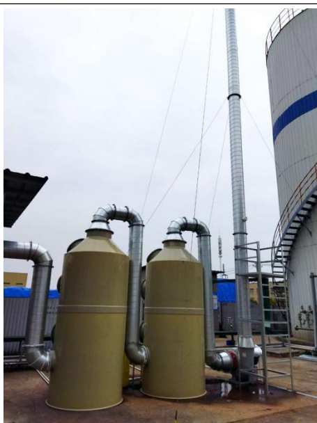
污水处理站废气排气筒 DA003
